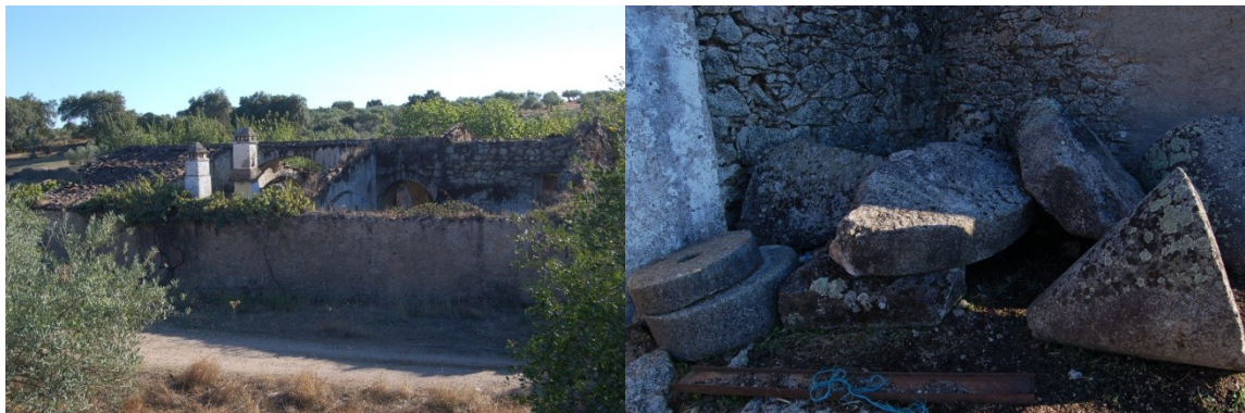
Foto n.º 21: Lagar de Casa Córdoba. El desplome del tejado permite ver los arcos del interior. La maleza impide el acceso. Foto n.º 22: Lagar de Pilonos, reconvertido en establo. En la entrada se conservan las piedras del molino.
